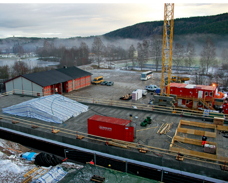
Baustelle in Rena zum Bau von Wohnungen für norwegische Armee-Angehörige aus Massiv-Holz-Mauern
